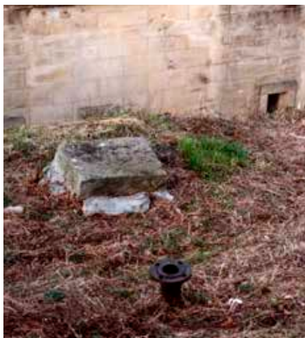
Registro del depósito de reserva, pegado a la contraescarpa. Al fondo, la escarpa. En primer plano un tubo aireador.
