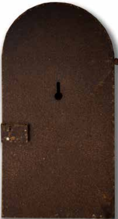
Puerta blindada interior con mirilla y cerradura. Lado interior.
