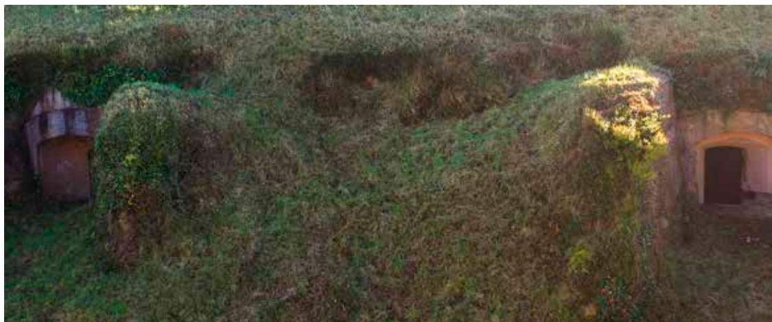
Exterior del frente norte de la batería acasamatada, en la que se aprecian dos cañoneras con sus muros de ala dañados y el desprendimiento de tierras entre ellos.
