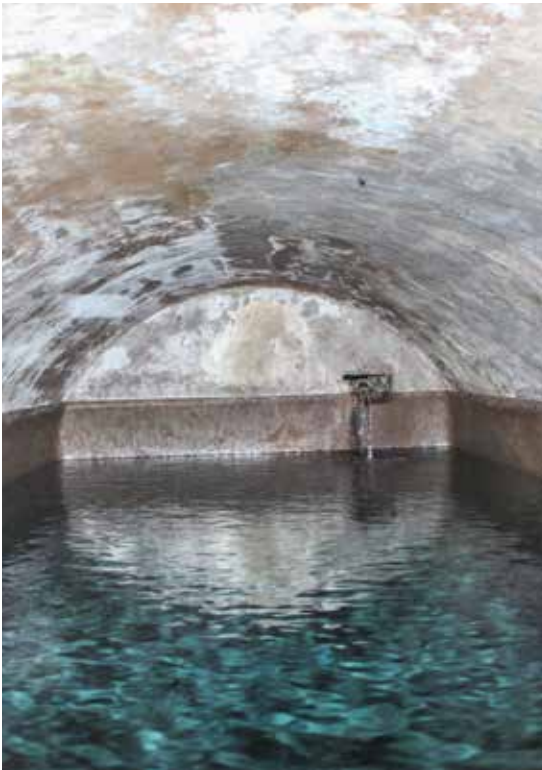
Interior de uno de los dos depósitos de distribución de agua, todavía en estado de uso.
