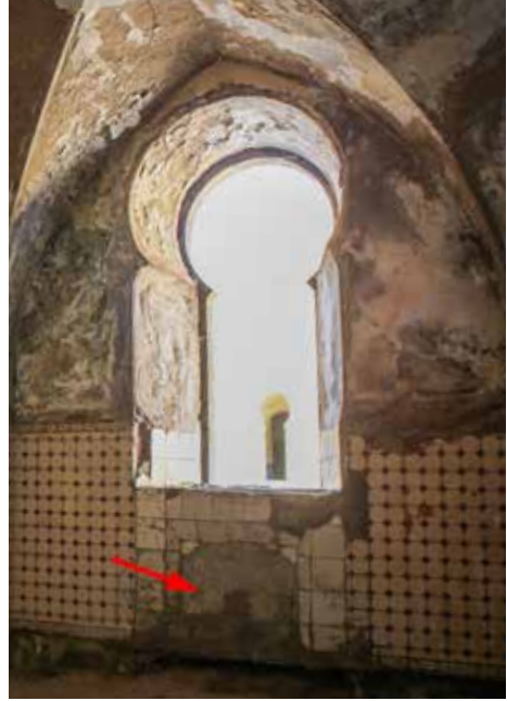
Chimenea cegada en el comedor del pabellón del gobernador del Fuerte, bajo la ventana. Posiblemente dispone de un tubo lateral para la salida de humo tal y como se aprecia en otra dependencia.
