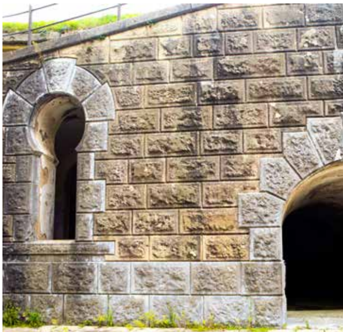
Ventana del pabellón del Ayudante vista desde el patio de armas, a la izquierda de la poterna que se dirige hacia la Obra del Centro y desde la que se accede al pabellón del Ayudante, oficial que, al igual que el Gobernador, podía vivir con su familia.
