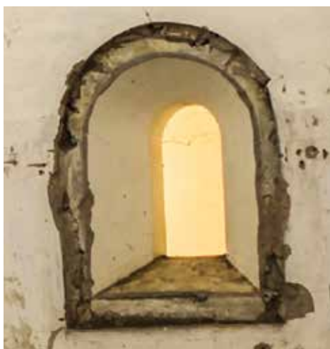
Ventana de iluminación o nicho de luces del repuesto de la batería de fuegos curvos de la Obra de la Derecha. Vista interior.
