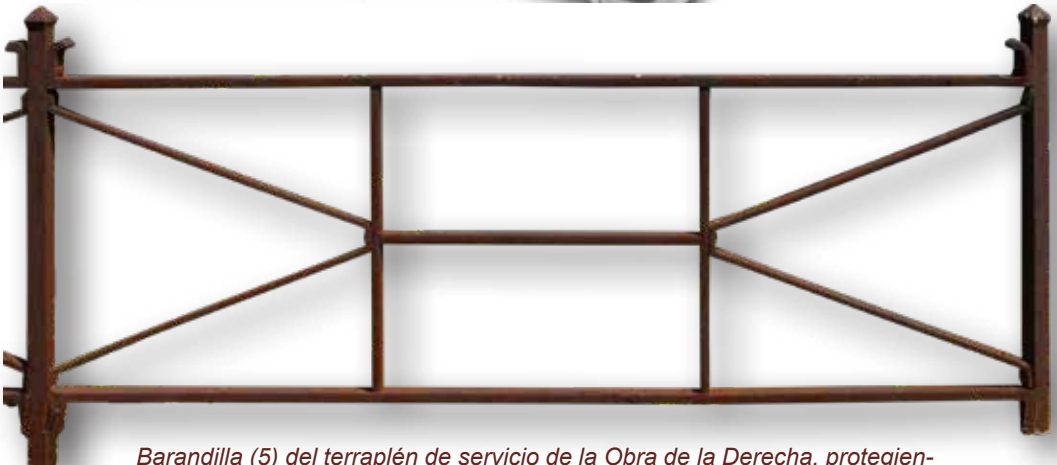
Barandilla (5) del terraplén de servicio de la Obra de la Derecha, protegiendo la caída hacia el patio oriental. Además de 4 tramos completos como el de la fotografía, se conservan parte de los postes del resto.
