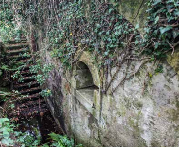
Exterior del depósito de distribución, cubierto por vegetación, a 1000 m del Fuerte. Se observa la escalera de acceso a los registros de la tubería de salida y el acceso al interior de uno de los dos depósitos que tiene en el interior.
