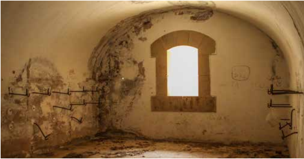
Frente sur de la batería acasamatada. Bóveda oriental. En los estribos de la bóveda sobresalen tres filas de soportes para los juegos de armas, parte de los cuales están cercenados.
