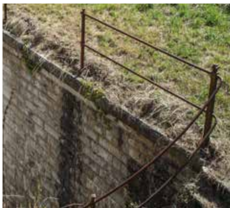
Barandilla (3) de la Obra del Centro. Se conserva la original aproximadamente en un 95%, habiéndose repuesto el resto
