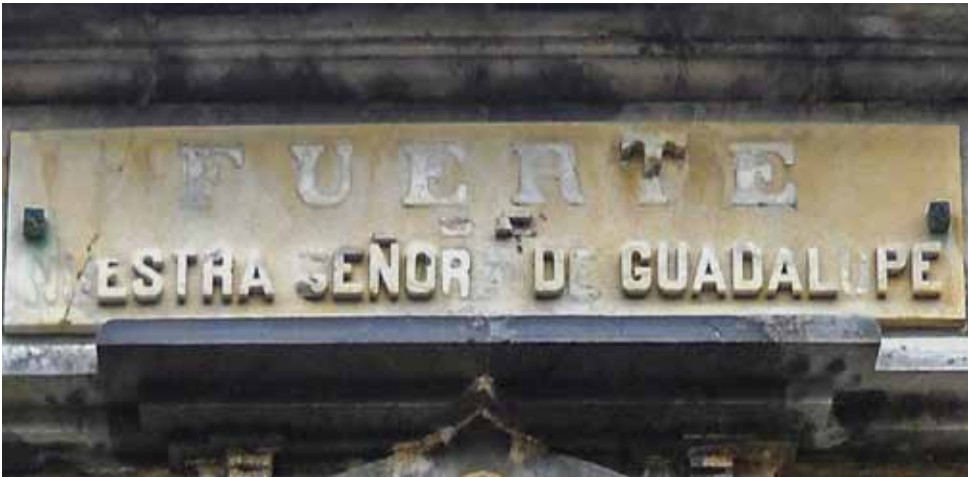
«Fuerte de Nuestra Señora de Guadalupe», sobre la imagen de la Virgen en la clave de la puerta principal. Se encuentra en mal estado, al faltar varias letras en relieve.
