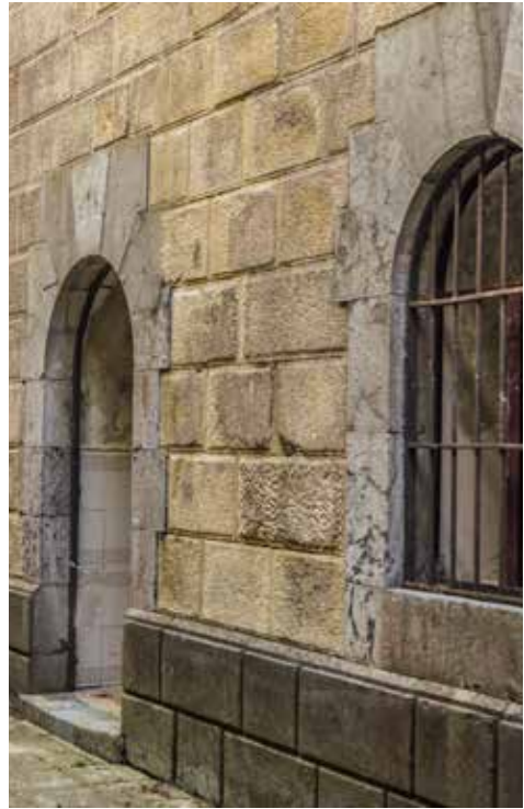
Ventana y acceso a las letrinas de tropa (1) en el patio de infantería. Una escuela-taller montó aseos modernos en esta estancia.
