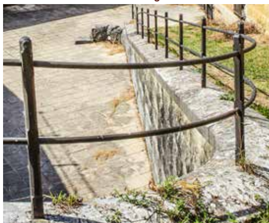
Barandilla (1) de la rampa de acceso a la Obra de la Izquierda, rodeando el patio principal. Se conserva la original aproximadamente en la mitad de su longitud, habiéndose repuesto el resto.
