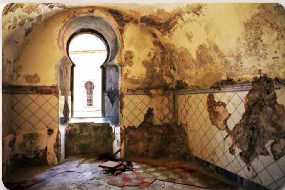
Alicatado de la cocina del gobernador en la Obra de la Izquierda.
