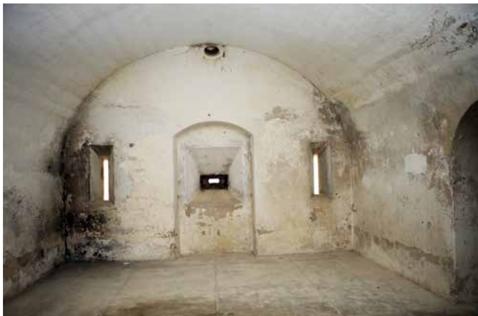
Bóveda de la planta inferior del cuartel de infantería que hace también la función de galería de escarpa. Se observa que está enfoscada convenientemente, cubriendo los estribos de mampostería y la bóveda de hormigón, confiriéndole un aspecto uniforme.
