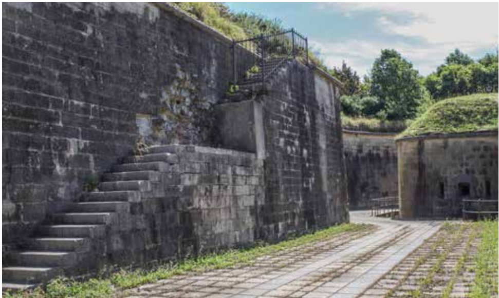
Escalera de contraescarpa situada en proximidad de la semicaponera oriental (4). El sector de escalera que falta fue volado por el Ejército con dinamita en el año 1980.
