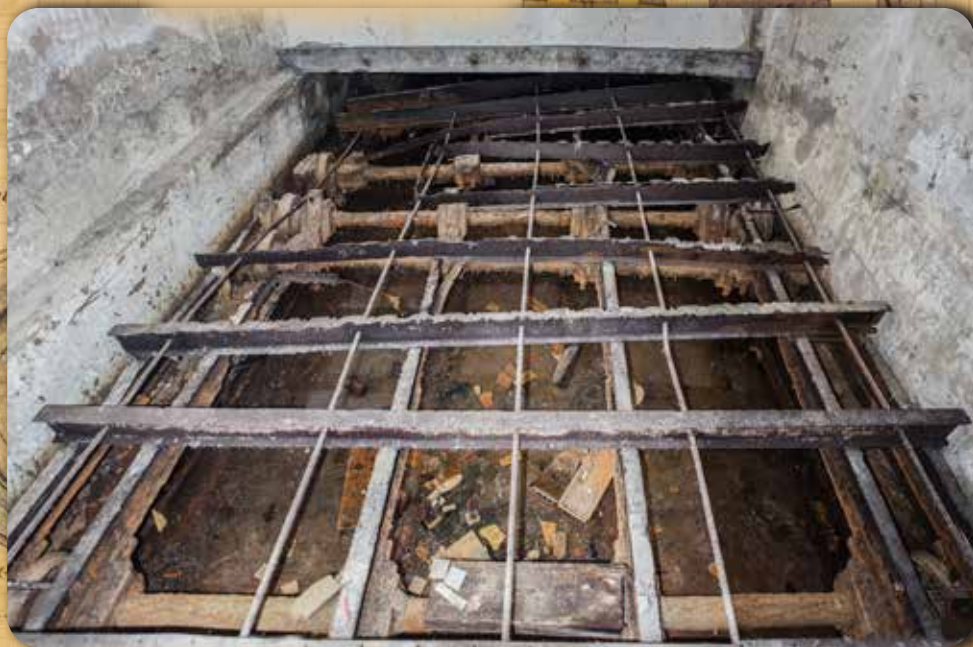
Estado del puente móvil de la puerta principal (2). Conserva la mayor parte de sus componentes metálicos, aunque bastante deteriorados.
