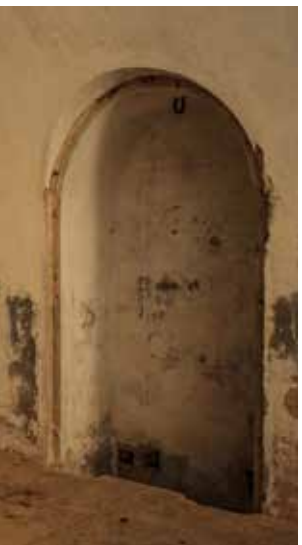
Estación superior en la bóveda oriental de la batería acasamada (1). Se conserva únicamente su caja.
