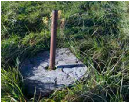
Sillar calizo de fijación del pararrayos oriental de la batería acasamatada, que protege el depósito de munición situado justo debajo.
