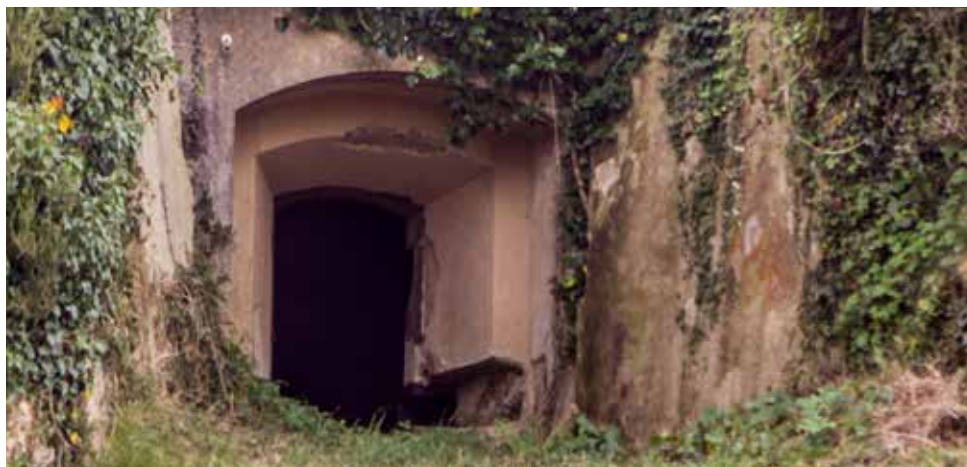
Batería acasamatada. Vista exterior de una de las cinco cañoneras septentrionales abiertas, con sus alas laterales. Varias alas están deterioradas, al igual que parte de los blindajes.
